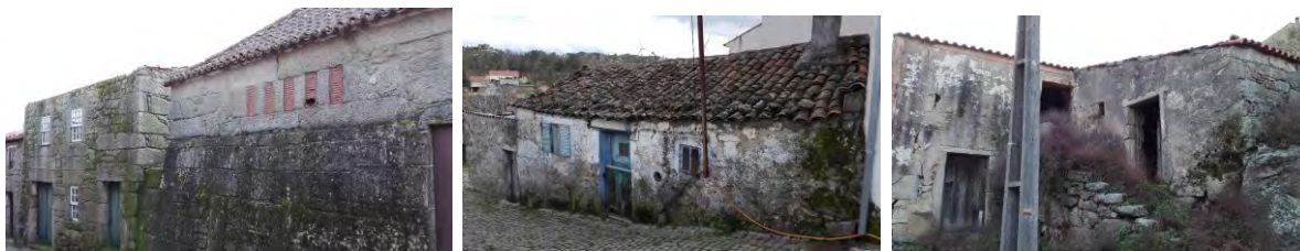
Figura 23. Exemplos de edifícios em estado crítico de conservação na ARU
